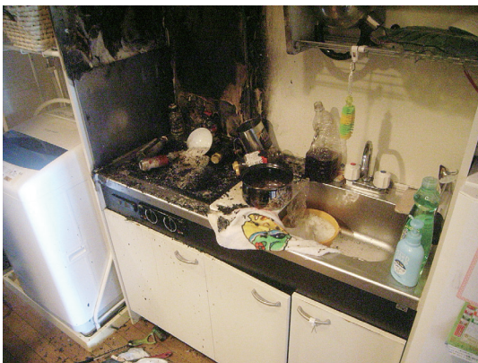
写真-1 消火後の写真
