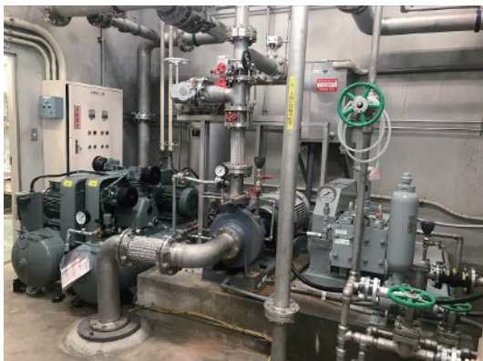
写真－５ ポンプ室
