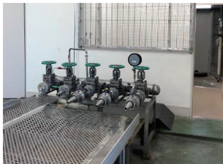
写真－2 ホース耐圧試験装置試験台
