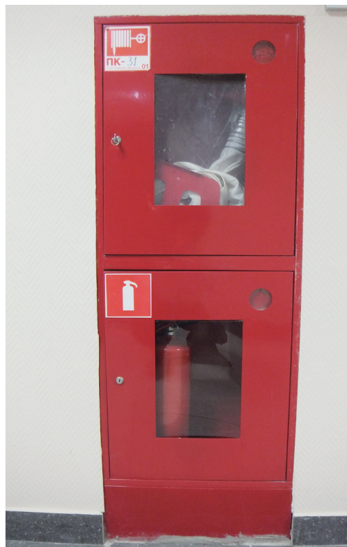
写真-5 会場内の消火栓及び消火器
