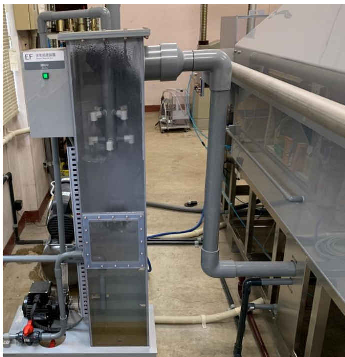
写真-4 排気処理装置
