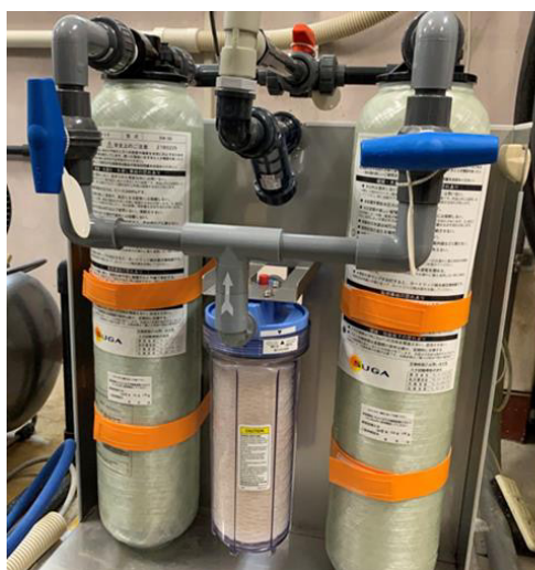
写真-5 イオン交換水製造装置
