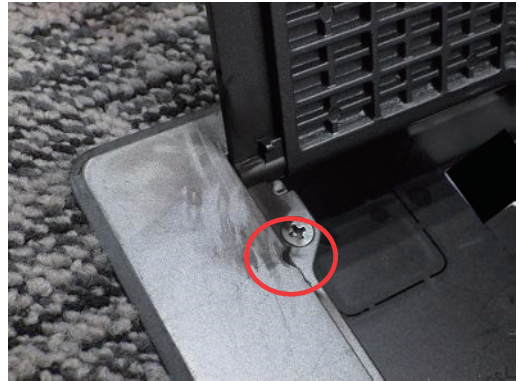
写真2-2 フロアコンセント付近の焼損状況
