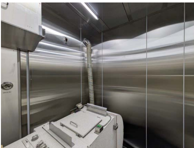
図6 煙試験機排煙ダクト
