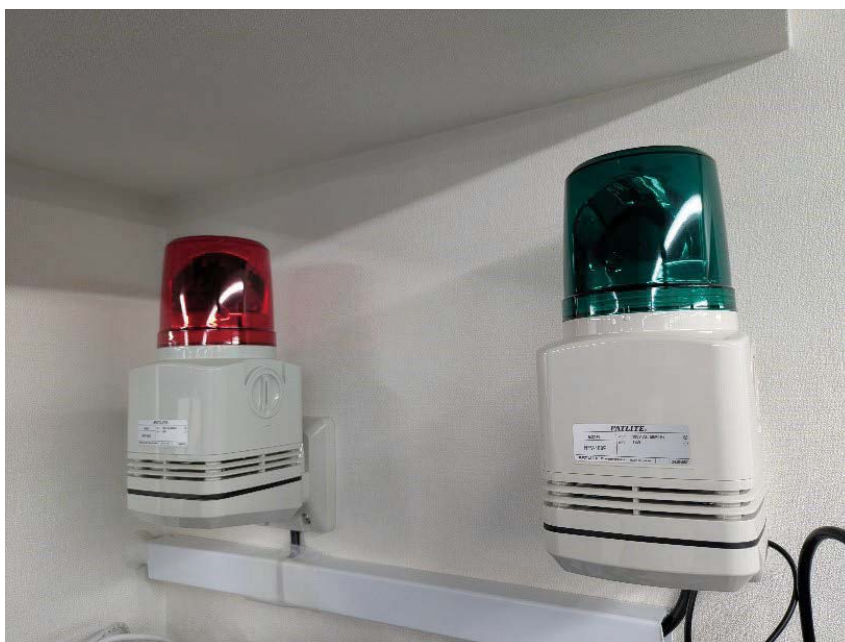
図10 警報用パトランプ（赤：1号機 緑：2号機）
