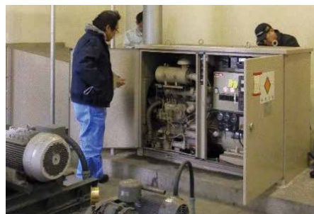
自家発電設備点検の様子
