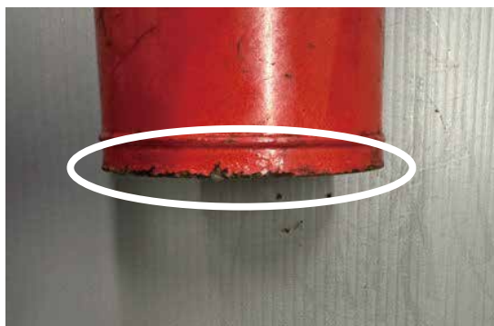
写真2-2③ 底部の腐食
