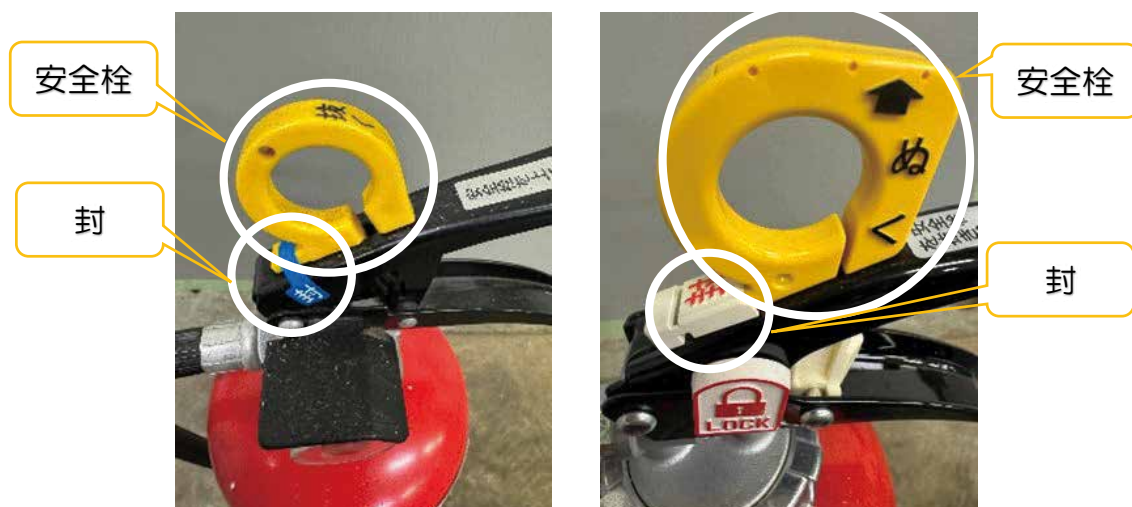
写真2-3-1①及び② 正常な安全栓と封の例
