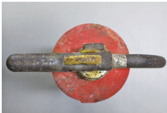
写真2-3-4② 安全栓及びレバーの表示の劣化
