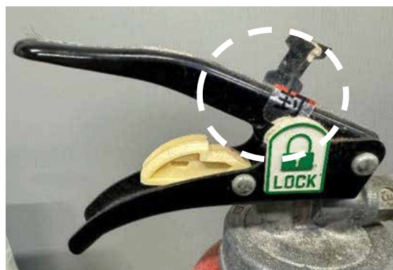
写真2-3-1③ 安全栓の欠落
