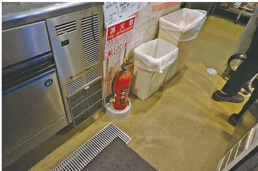
写真1-2 厨房に設置してある消火器の例（設置台置き）
