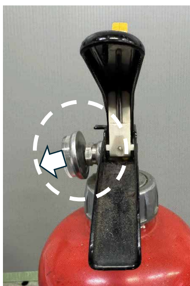
写真2-3-2② 保護カバーが欠落し、指示圧力計が変形しているもの
