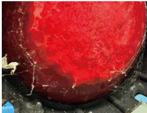
写真2-2⑤ コーティング樹脂の劣化
