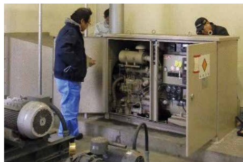
自家発電設備点検の様子
